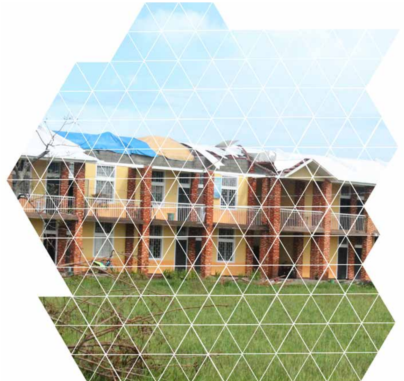
We Effects hus på Filippinerna som HSB varit sponsor till. De klarade sig undan tyfonen med endast några skador på taket.
