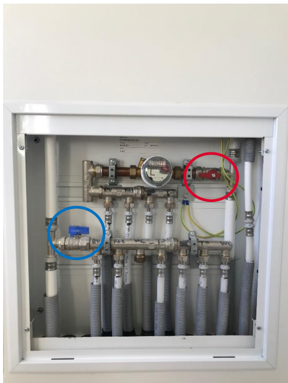
Bild 3. Fördelarskåp för vatten, röd ventil är varmvatten och blå ventil är kallvatten.
