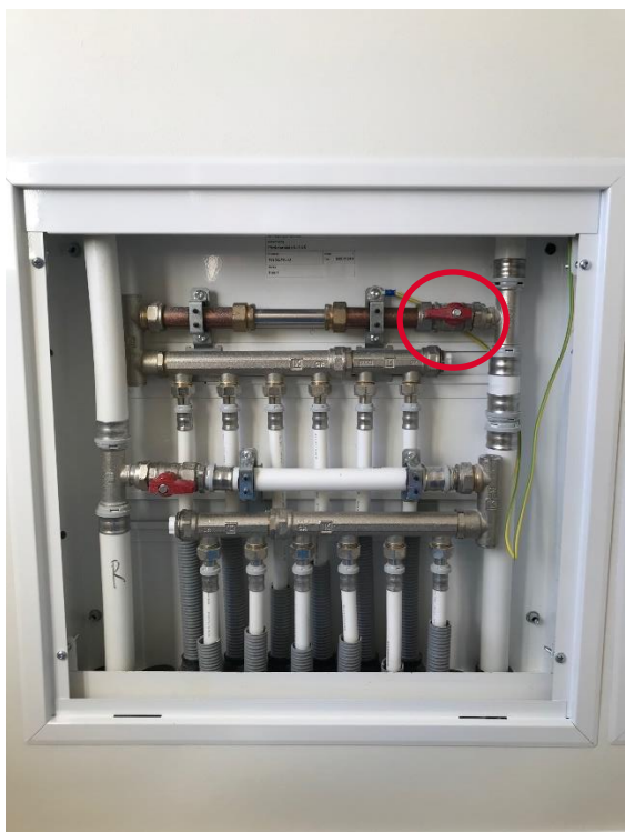
Bild 4. Fördelarskåp för värme, se position av ventil.
