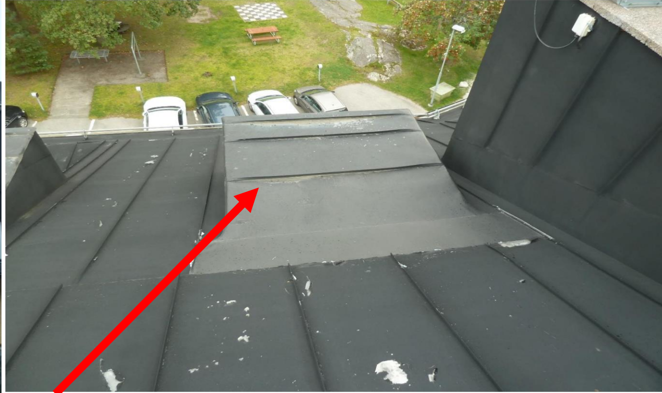
Bild 2. Det finns takkupor som fått ny plåt men till en mindre lyckad lösning då den har kvar låglutning och falsar på tvären som samlar vatten och is. Is spränger och tar sig in genom falsarna.
