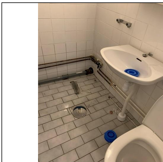
Rör genomföringar i våtzon 1.
