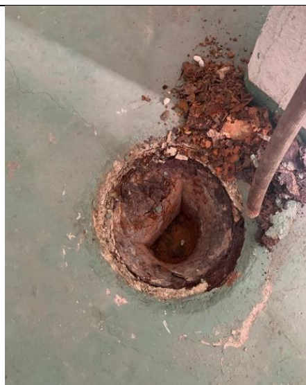
Rostangripen gjutjärnsbrunn i källare
