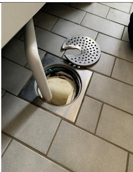
Golvbrunn saknar klämring
