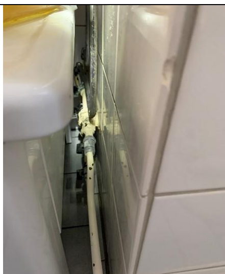
Rör genomföringar i våtzon 1.
