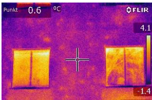
IR-bild på del av fasad visar stort värmegenomsläpp genom fönster
