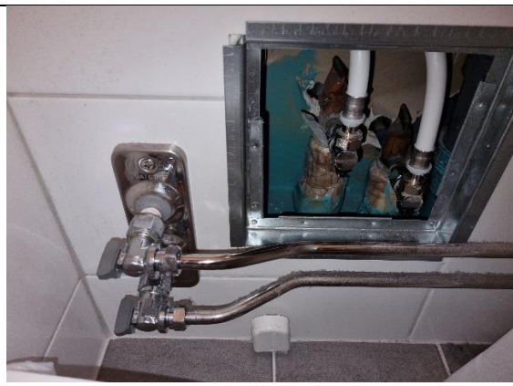
Bristfällig isolering på befintliga tappvattenledningar. Onödig energiförlust.
