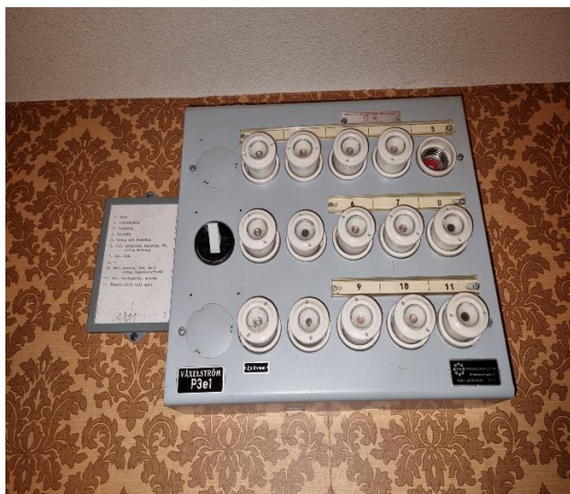
El-central med porslinsäkringar, saknar jordfelbrytare.
