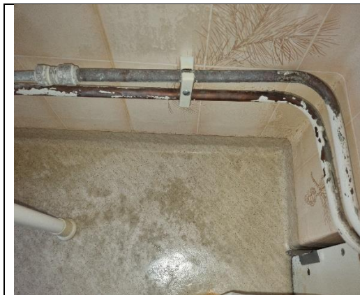
Synliga tappvattenrör i duschzon.
