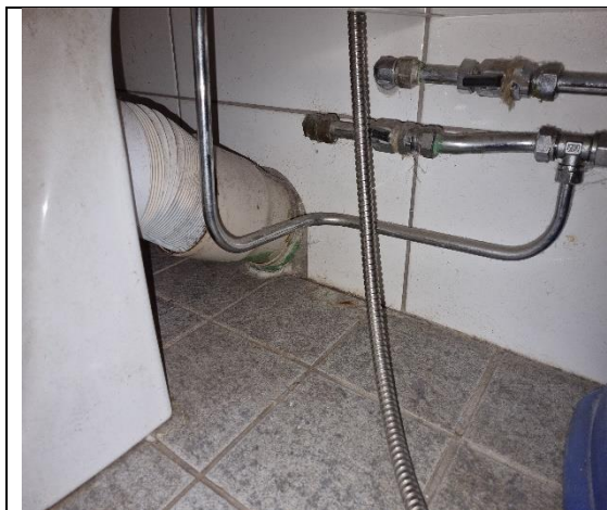
Avlopp i golvvinkeln, bristfällig tätning
