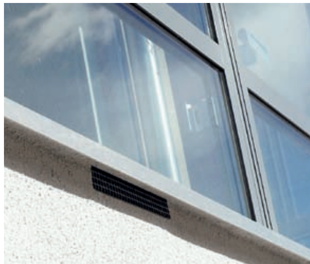
Ett exempel på dolt luftintag under fönsterbleck
