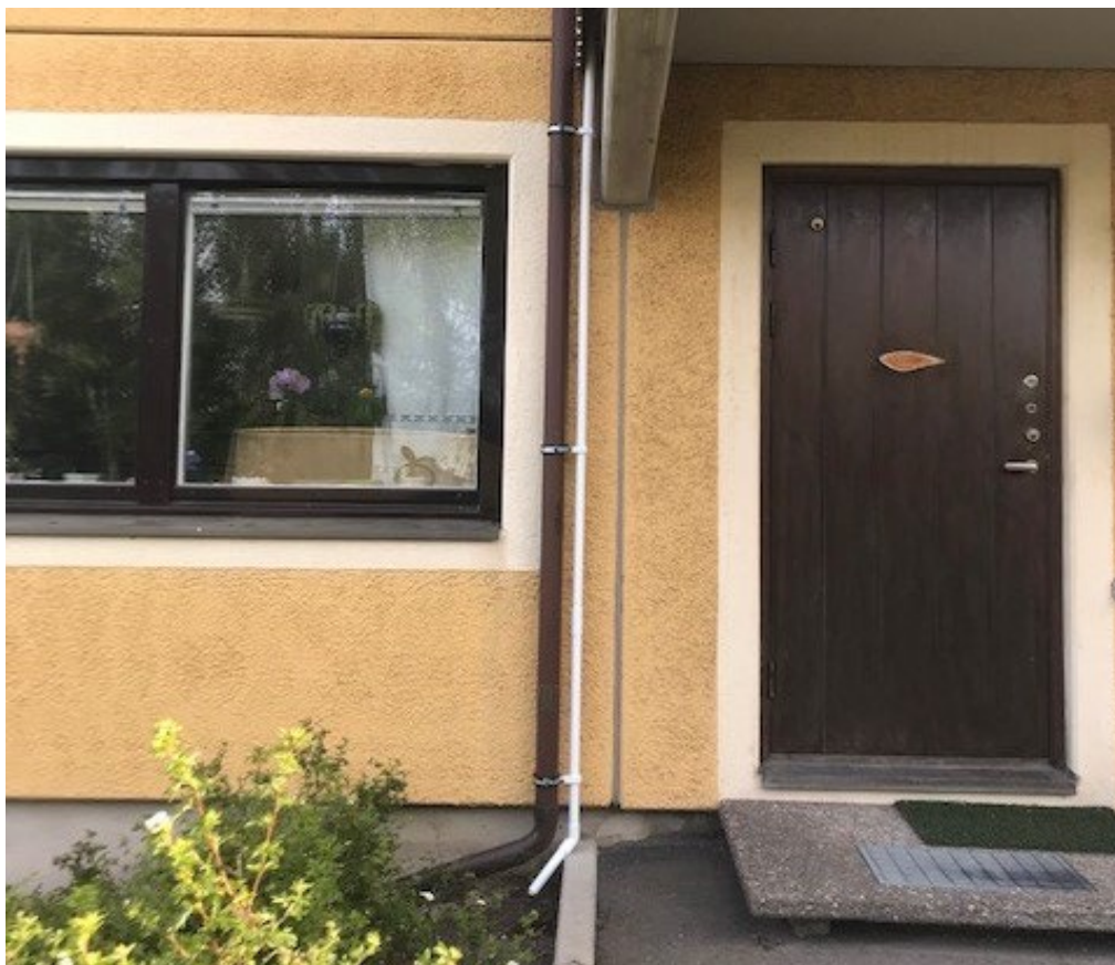
Exempelbild på befintlig provinstallation i föreningen.
