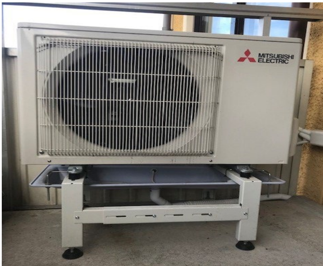
Exempelbild på befintlig provinstallation i föreningen.
