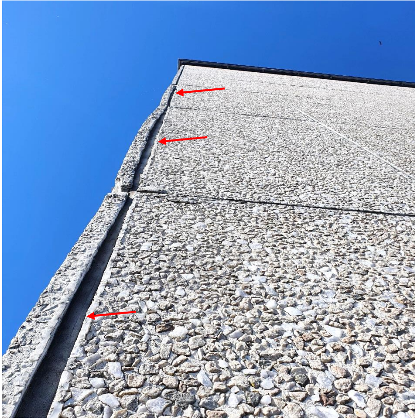
Bild 8, Deformerade fasadelement. Kometvägen gavel mot öst.
