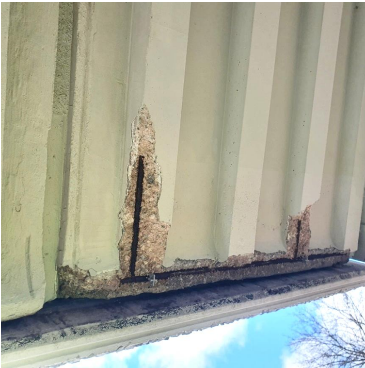
Bild 11, Spjälkad framkant före skrotning. Port 5 våning 1.
