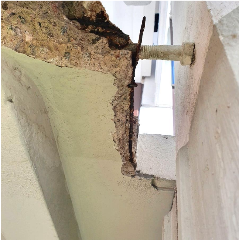
Bild 14 , spjälkad kant vid infästning. Port 5.
