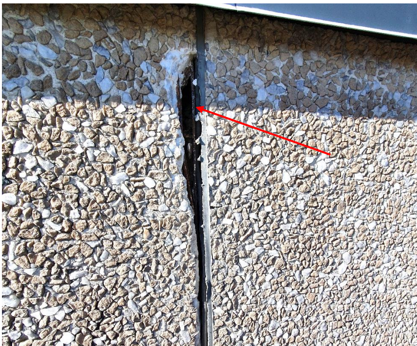
Bild 3, Spjälkad elementkant, Meteorvägen, gavel mot Öst.
