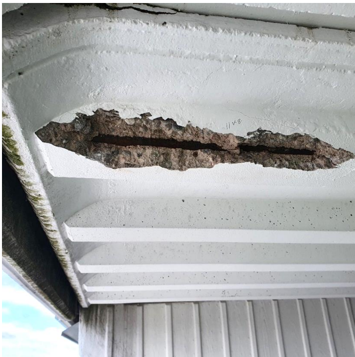
Bild 13, Skada i framkant efter skrotning. Port 11, våning 8
