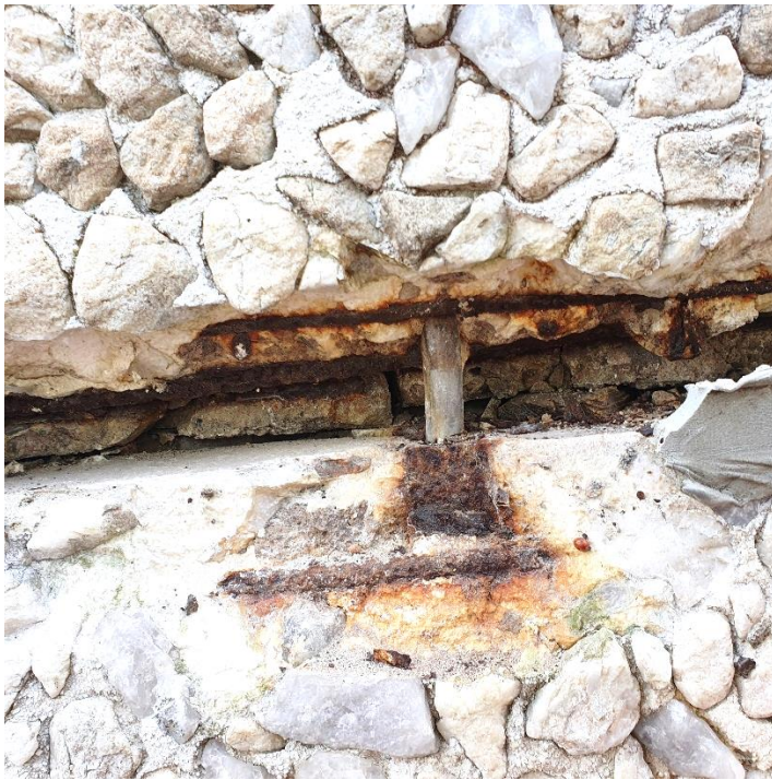
Bild 4, Skador i anslutning till hylsor till styrdubb.
