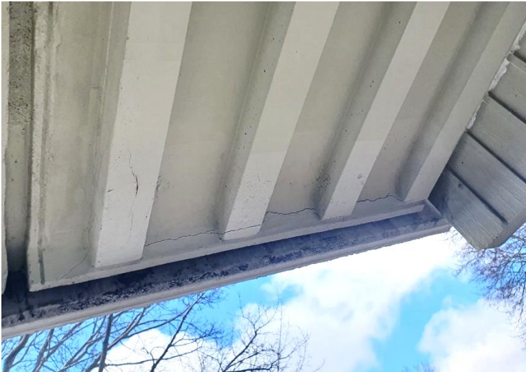
Bild 11, Spjälkad framkant före skrotning. Port 5 våning 1.
