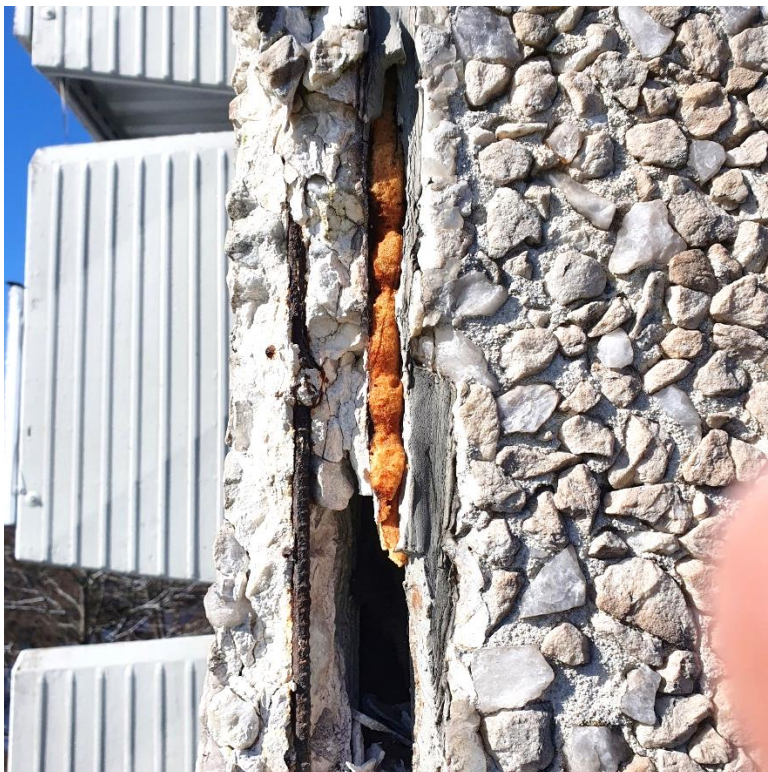
Bild 7, sönderfruset element på våning 4, Kometvägen, gavel mot Öst.
