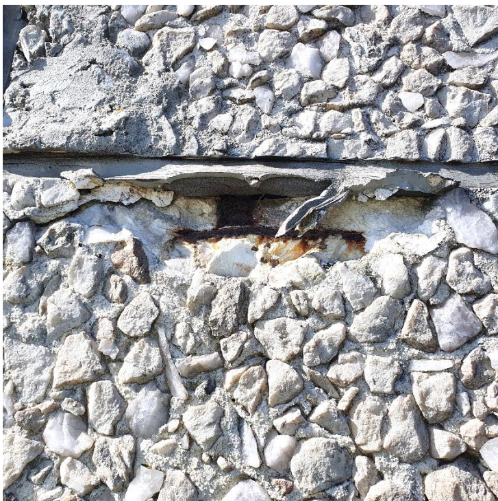
Bild 5, Skador i anslutning till hylsor till styrdubb. (generellt)
