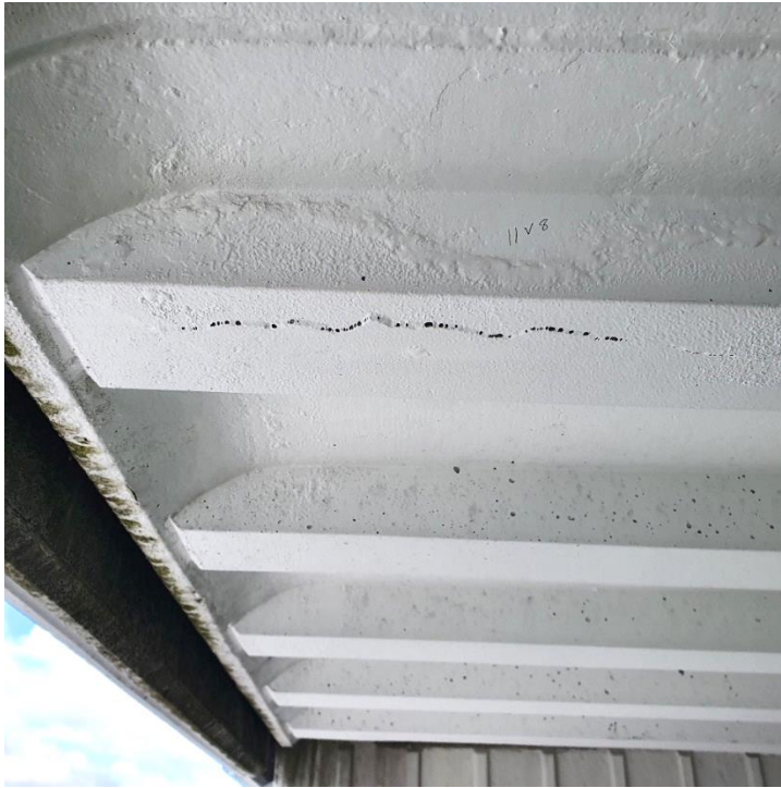
Bild 12, Fuktutfällningar vid skada i framkant före skrotning. Port 11, våning 8
