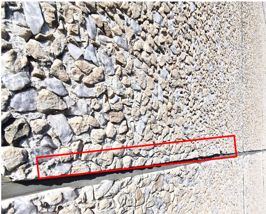
Bild 1, Typskada sprickor i fasadelement, Komet- och Meteorvägen.
