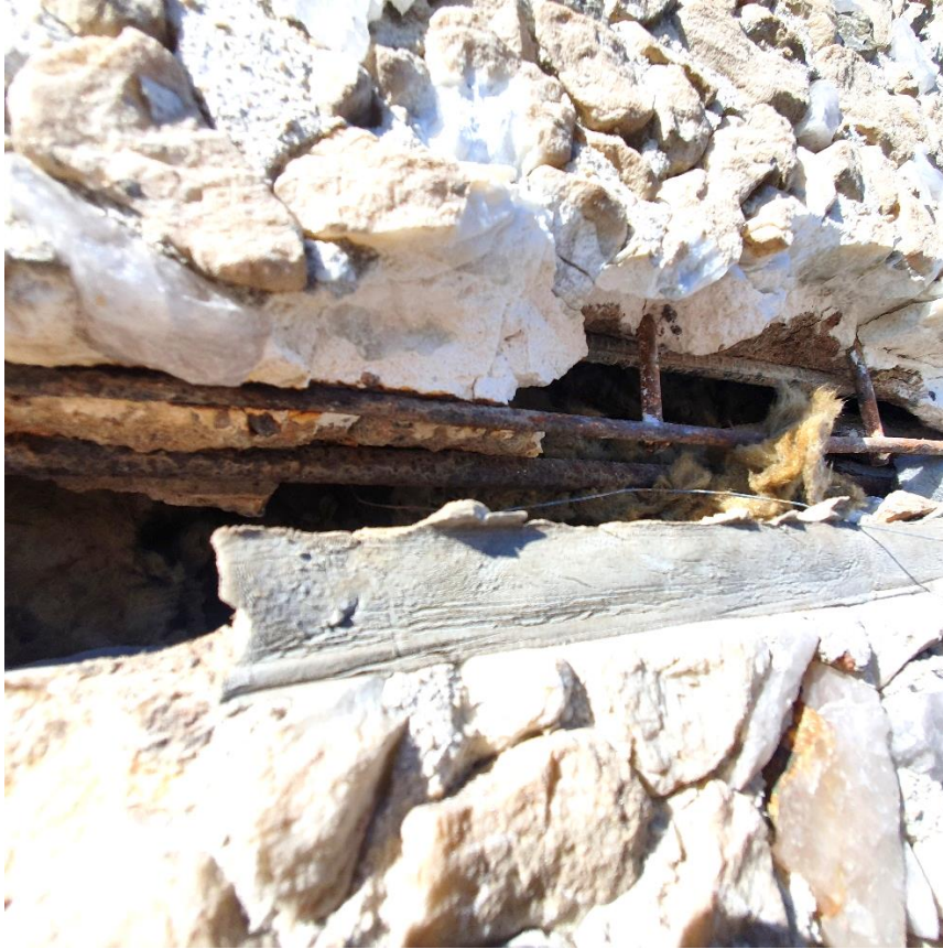
Bild 2, Spjälkskada och armeringskorrosion i nederkant, Kometvägen, gavel mot Öst.
