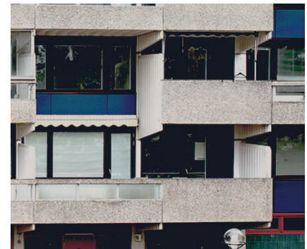
HUS B, Ytterbåge Typ B2, B2(S) Utstickande balkong, natursten/betongfront, dubbelhögt balkongrum, rillor under balkongplattor, skärmvägg av betong, konsoler av betong mitt under nedersta balkongplattor
