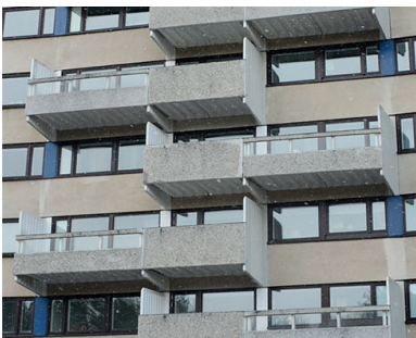
HUS B, Typ B3, B3(S) Utstickande balkong, natursten/betongfront, dubbelhöga balkongrum, rillor under balkongplattor, skärmvägg av betong, konsoler av betong mitt under balkongplattor
