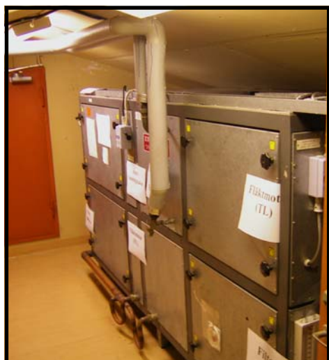
Fläktrummet i hus 29
