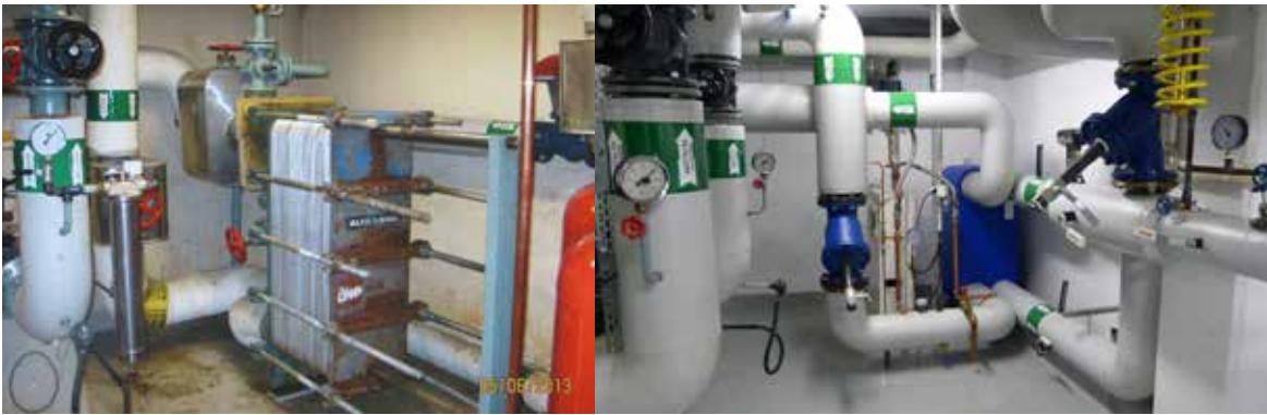
Ovanstående bild visar före och efter ombyggnaden av en undercentral.
