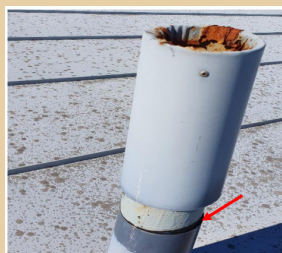
Foto 5. Ytterligare exempel på bristfälligt utförande vid avloppsventilation. Pil visar glipa mellan över och understos med uppenbar risk för inträngande vatten
