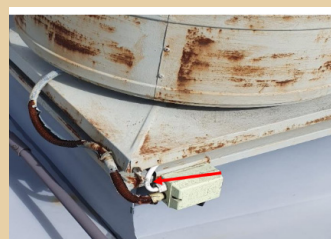
Foto 3. Ventilationsanordningar med korrosionsangrepp förekommer generellt. Även vissa el-ledningar i stål uppvisar korrosionsangrepp.
