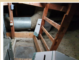
Foto 12. Uppstigningsluckor företrädesvis placerade rakt ovanför lucka från trapphus. Vilplan och plattformar saknas vilket kan försvåra tillträde vid servicearbeten e d.
