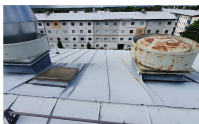
Foto 1. Taken har generellt slitet färgskikt och ställvis mindre korrosionsangrepp.
