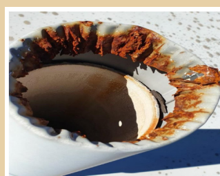
Foto 7. Ytterligare exempel på stös med otätt utförande. Stös ej vikt över stammen, risk för läckage.
