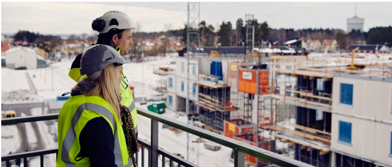
Byggandet tog fart ordentligt under 2010. Här inspekterar HSBs projektledare Elin Johansson och Rikard Billkär uppförandet av projektet Rosenkällan i Linköping.
