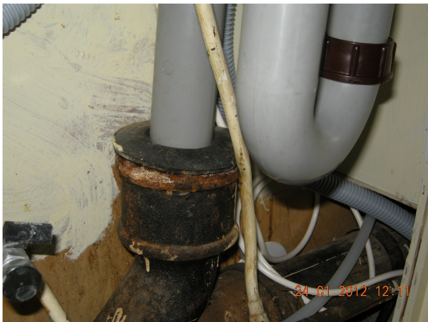
Rostigt avlopp i diskbänksskåp
