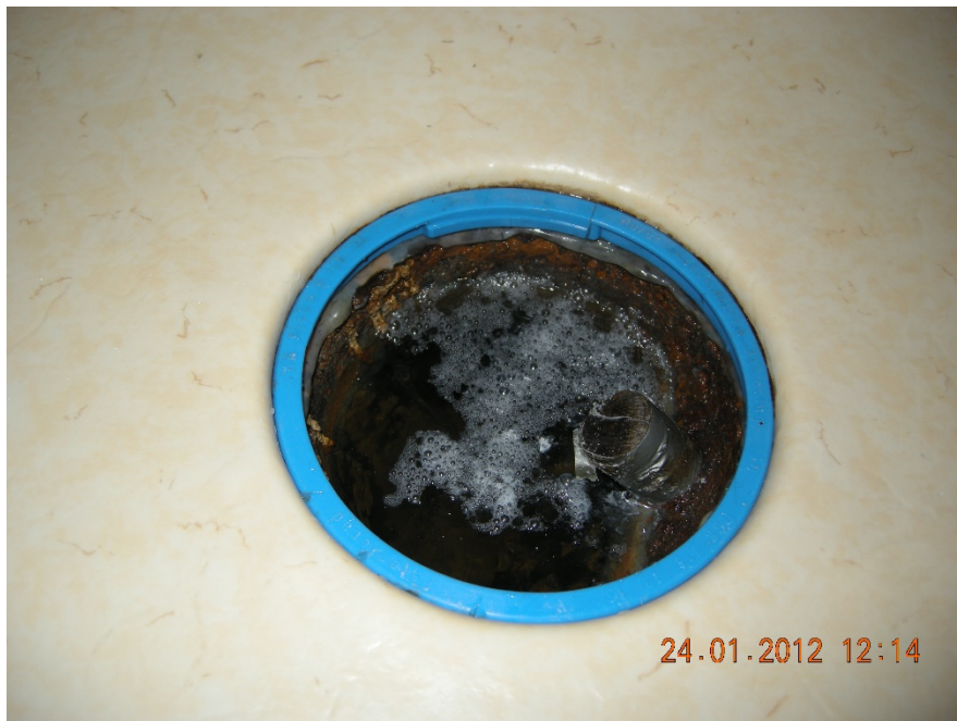
Gammal rostig golvbrunn
