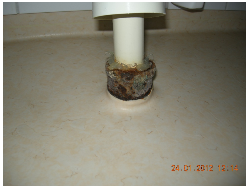
Rostigt avlopp i badrumsgolv
