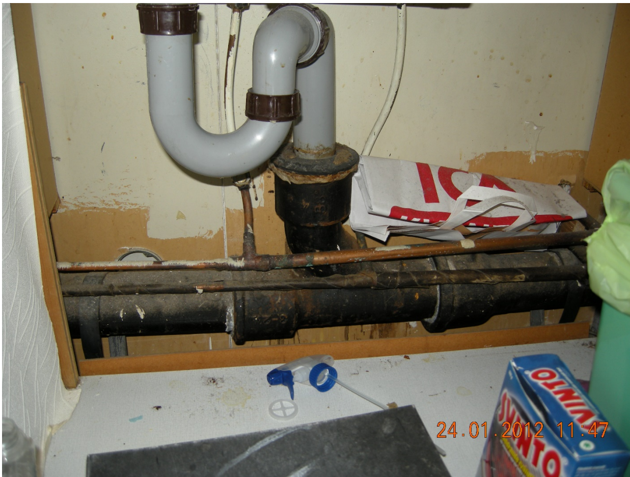
Diskbänksskåp med rostigt avlopp och otät botten
