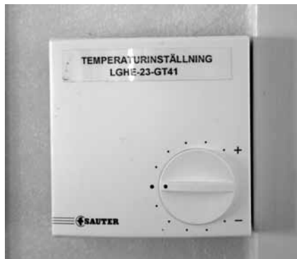
Huvudtermostaten sitter i hallen brevd teknikrummet.
